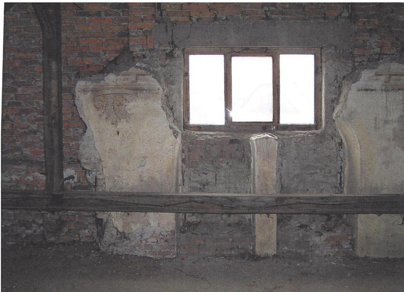
Zachovalé torzo interiéru synagógy.
